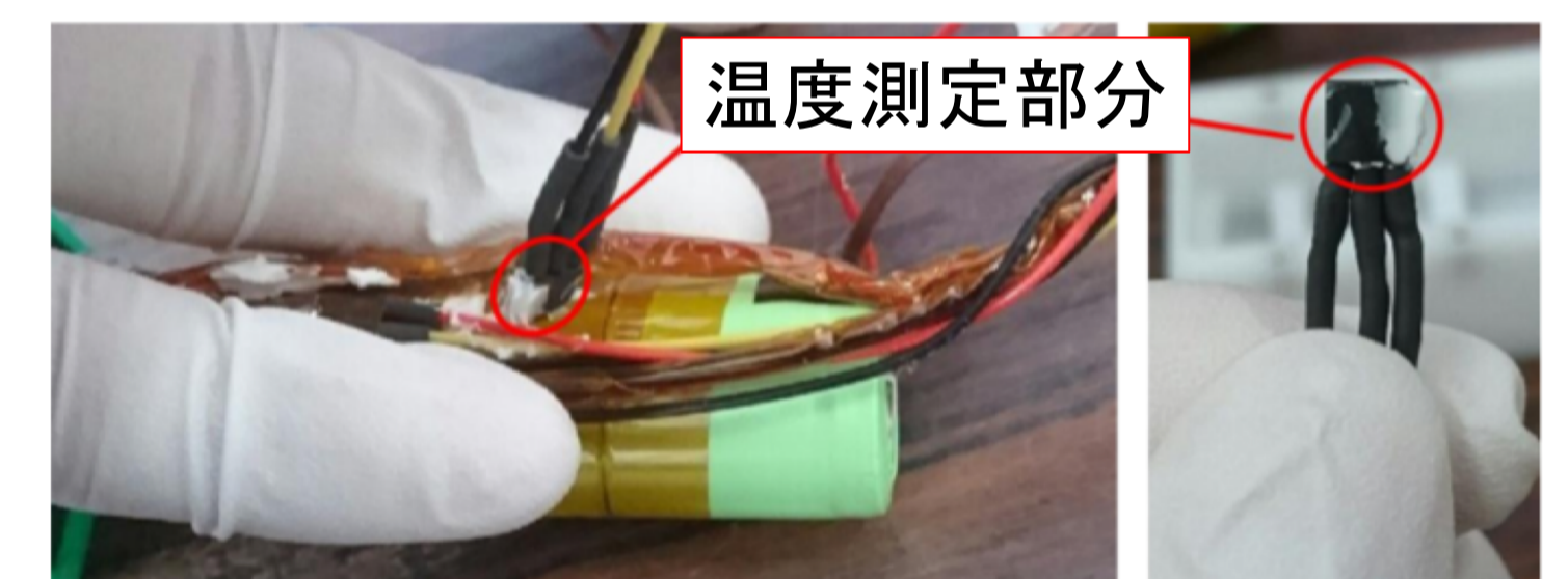
バッテリー温度センサ接触不良箇所
